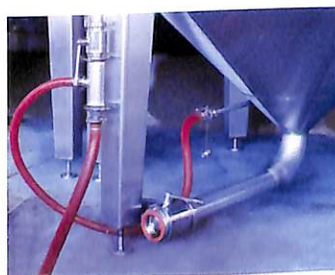
Fondo Conico con dispositivo "Sluice Point"
