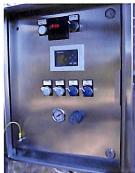
Quadro di controllo
