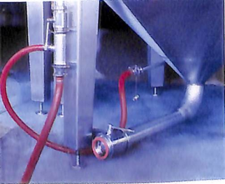
Fondo Conico con dispositivo "Sluice Point"
